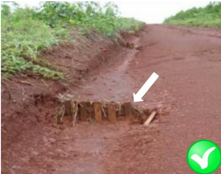
Figura 2: Detalle de dissipadores de energía en cunetas de desagüe prolongadas y con pendientes.
